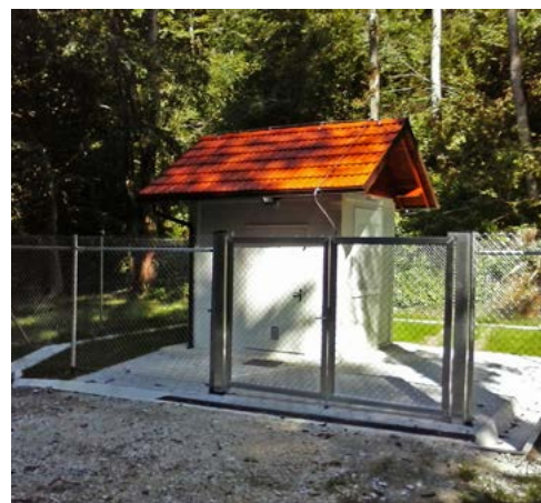
Črpališče pri novozgrajeni vrtini na Kolovcu.
